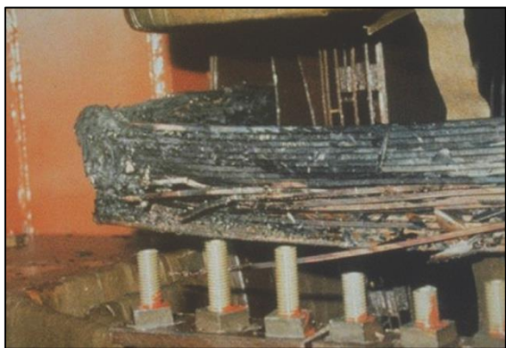
Термическое повреждение силовых трансформаторов вследствие магнитной бури. Провинция Квебек, Канада (13 марта 1989 г.).
